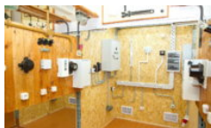
Мастерская по монтажу и обслуживанию осветительных электростановок
