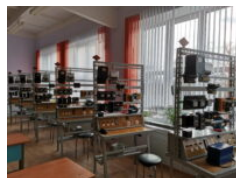
Мастерская по обслуживанию силового электрооборудования
